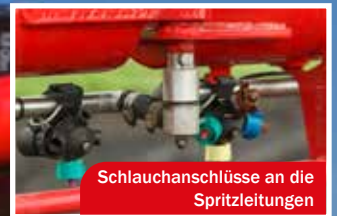
Schlauchanschlüsse an die Spritzleitungen
