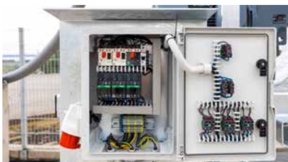
Armoire de commande confortable
